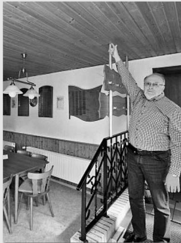
Im Schützenheim: Vorsitzender Jürgen Kutsche zeigt die Schäden an der alten Holzdecke. Foto: Hensel
